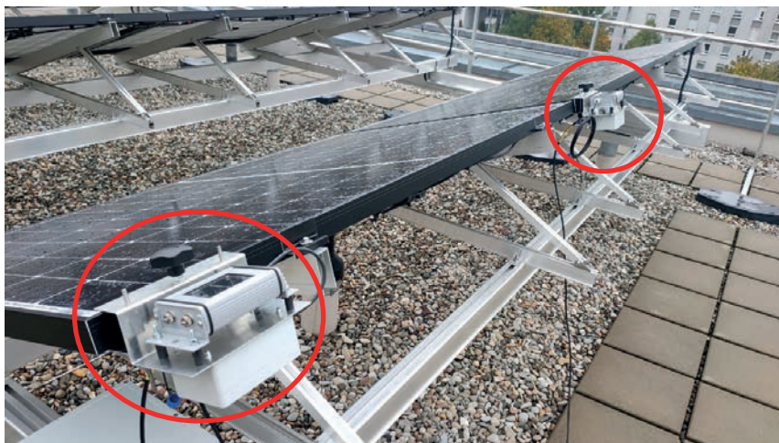
Abb. 8: Montage der G-, T-Sensoren an Modulen des mc-Si-PV-Strings (rot markiert)
