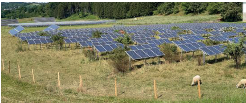
Abb. 1: PV Freiflächenanlage mit über 4700 Modulen und 976 kWp installierter STC-Leistung
