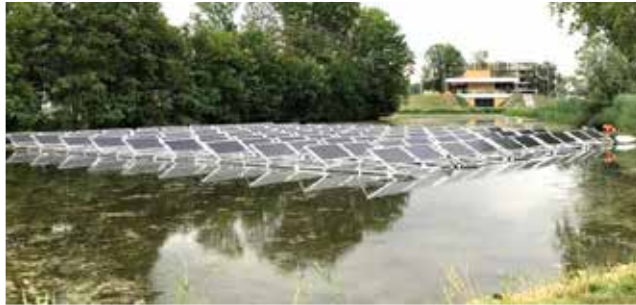
Abb. 2: Aufgeständerte bifaziale PV Module auf Wasseroberfläche (Quelle Sunfloat, NL)
