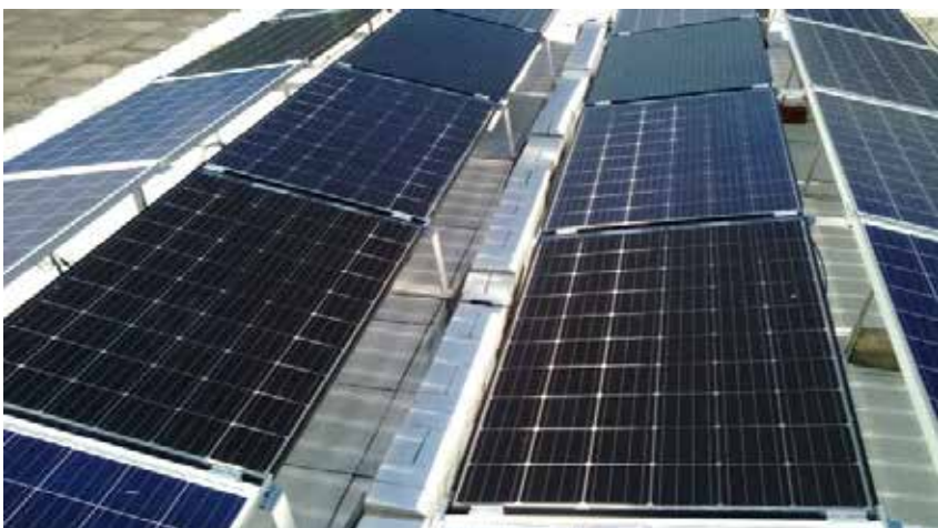
Abb. 4: Foto aufgeständerte bifaziale PV Module auf Flachdach (System G+: Alumero, AT)
