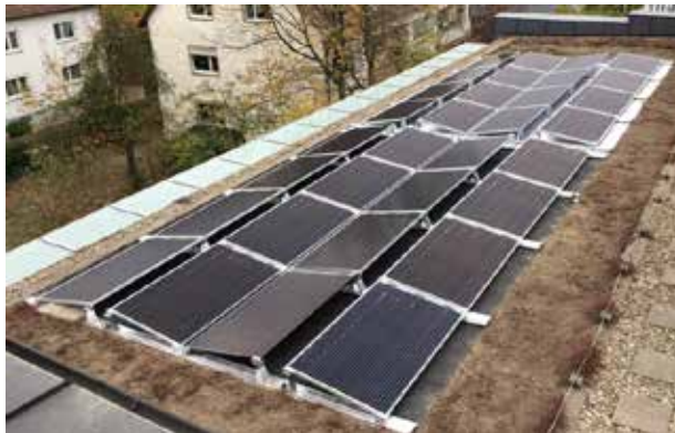
Abb. 5: Flachdachanlage mit bifazialen Solarmodulen und verschiedenfarbigen Dachfolien
