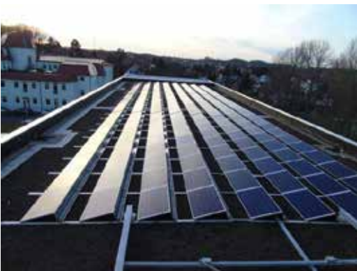
Abbildung 3: PV-Anlage auf Technikum II
