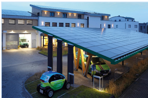
Solarcarport mit Ladesäulen in Hilden (©Bäckerei Schüren)
